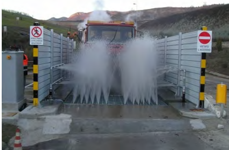
Figura 7.10 – Impianto lavaggio gomme e mezzi
