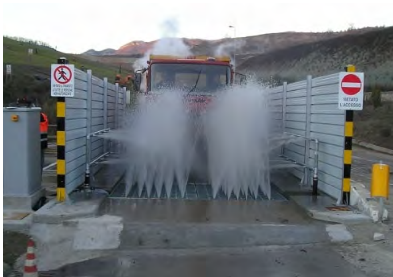
Figura 7.5 – Impianto lavaggio gomme e mezzi
