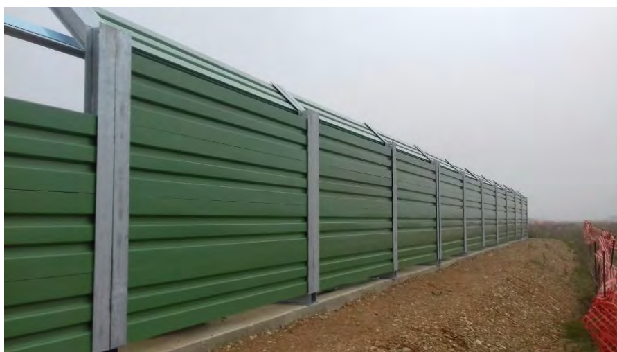
Figura 7.3 – Esempio Barriera antirumore
