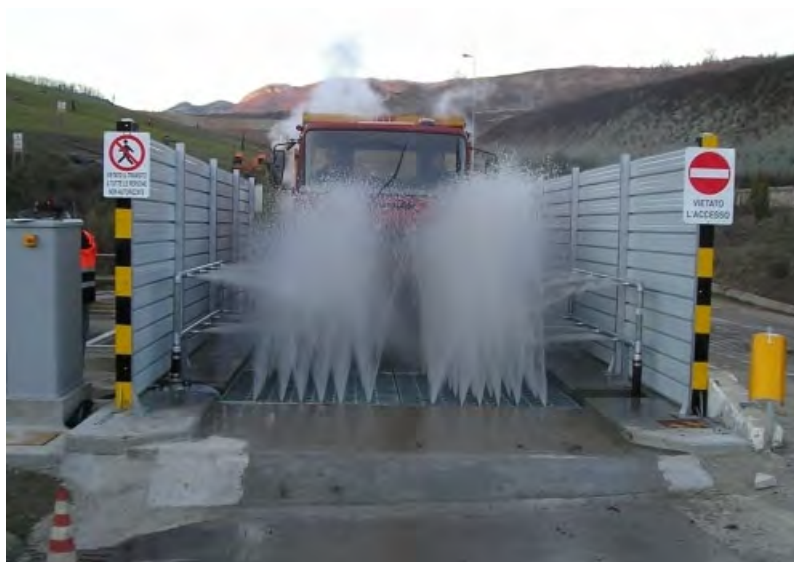
Figura 7.9 – Impianto lavaggio gomme e mezzi
