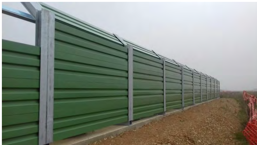
Figura 7.3 – Esempio Barriera antirumore
