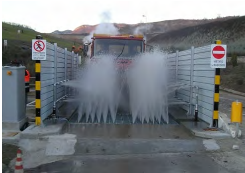
Figura 7.9 – Impianto lavaggio gomme e mezzi
