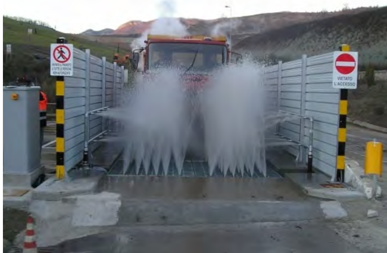
Figura 7.7 – Impianto lavaggio gomme e mezzi
