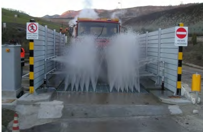
Figura 7.5 – Impianto lavaggio gomme e mezzi
