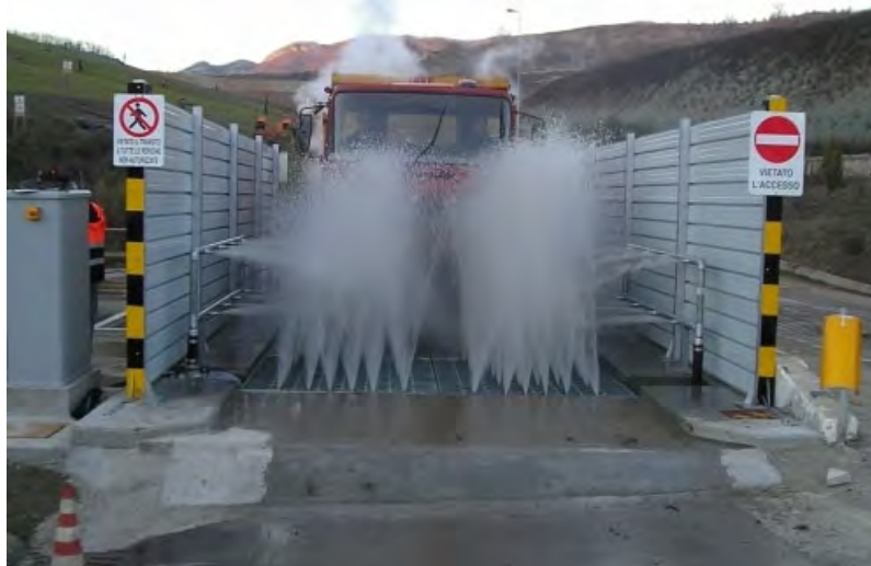
Figura 7.11 – Impianto lavaggio gomme e mezzi
