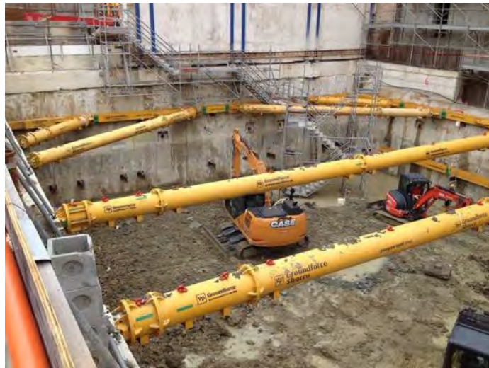
Figura 10.1 – Esempio puntoni metallici
