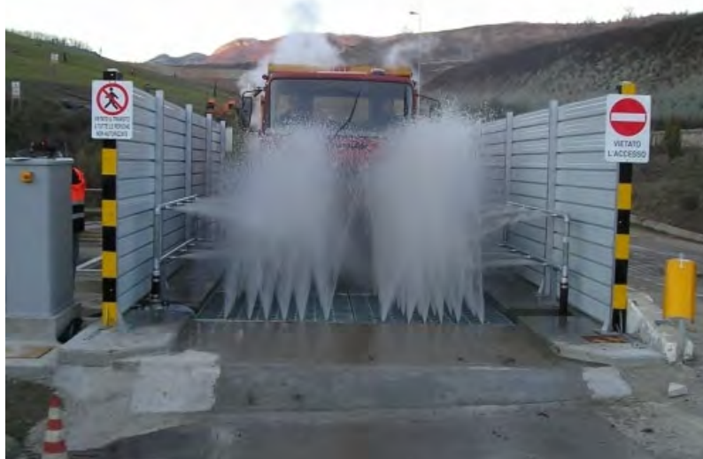
Figura 7.5 – Impianto lavaggio gomme e mezzi
