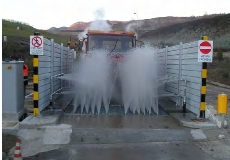
Figura 7.8 – Impianto lavaggio gomme e mezzi
