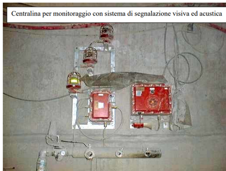
Figura 2.4 – Esempio di centralina di monitoraggio automatico
