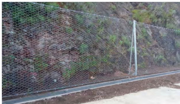
Figura 6.22 – Esempio reti di protezione contro caduta massi.
