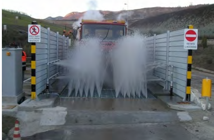
Figura 7.15 – Impianto lavaggio gomme e mezzi
