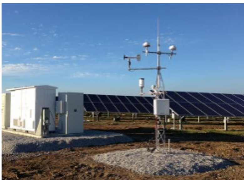
Figura 6 – Esempio di stazione meteorologica
