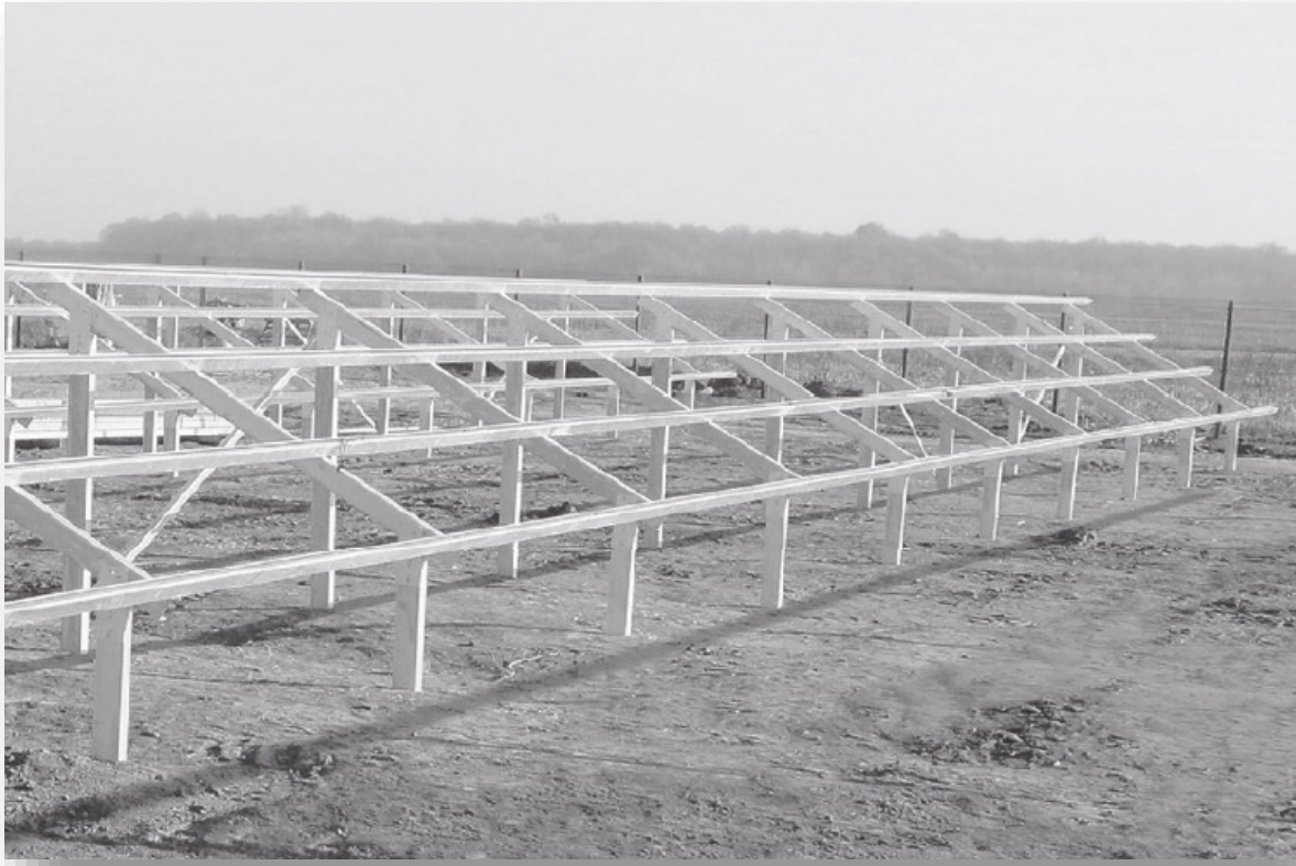
Figura 2 - Esempio struttura fissa
