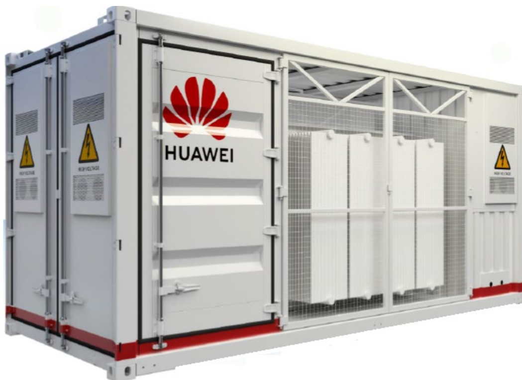
Figura 12 - Esempio stazione di trasformazione di campo
