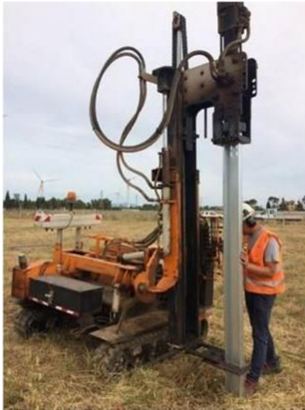
Figura 1: Esempio di supporto costituito da palo in acciaio infisso direttamente nel terreno mediante battipalo.
