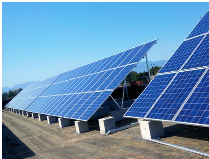
Figura 6: Esempio di impianto fotovoltaico con fondazioni formate da zavorre costituite da plinti in cemento.
