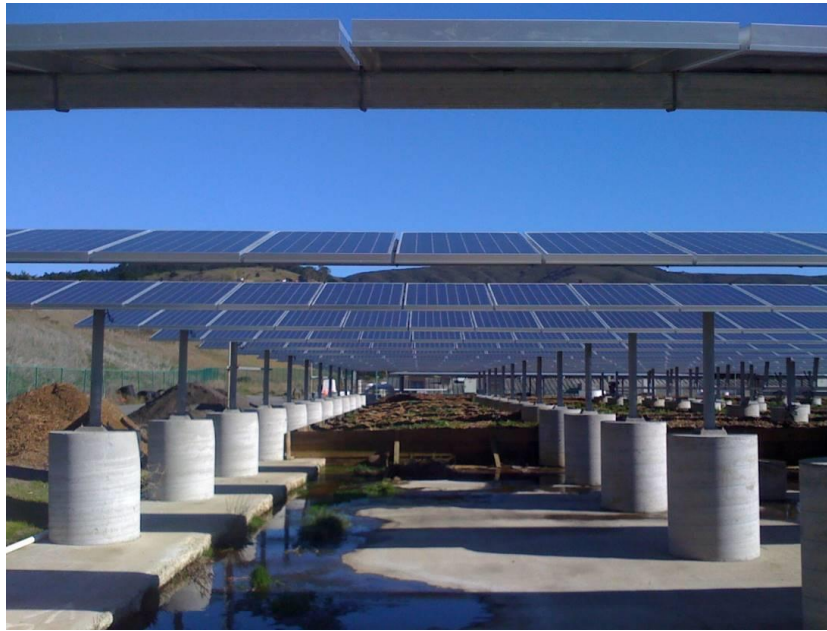
Figura 5: Esempio di impianto fotovoltaico con fondazioni formate da zavorre costituite da plinti in cemento.
