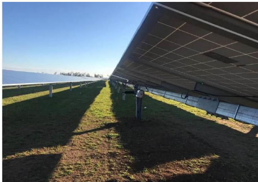
Figura 2: Esempio di impianto fotovoltaico realizzato con supporti costituiti da pali in acciaio infissi direttamente nel terreno. Gli impatti sul suolo sottostante risultano essere minimizzati.
