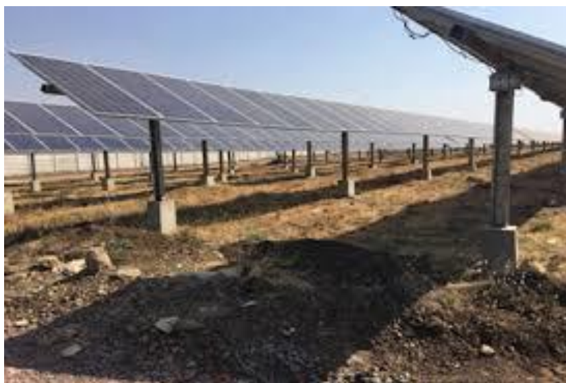
Figura 4: Esempio di impianto fotovoltaico con fondazioni ottenute mediante perforazione del terreno e successiva creazione del palo di fondazione con getto di cemento.
