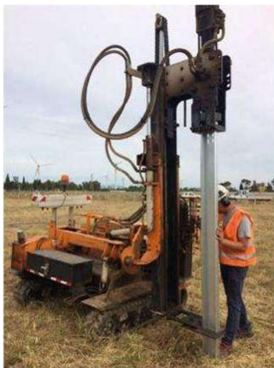
Figura 38: Esempio di supporto costituito da palo in acciaio infisso direttamente nel terreno mediante battipalo.
