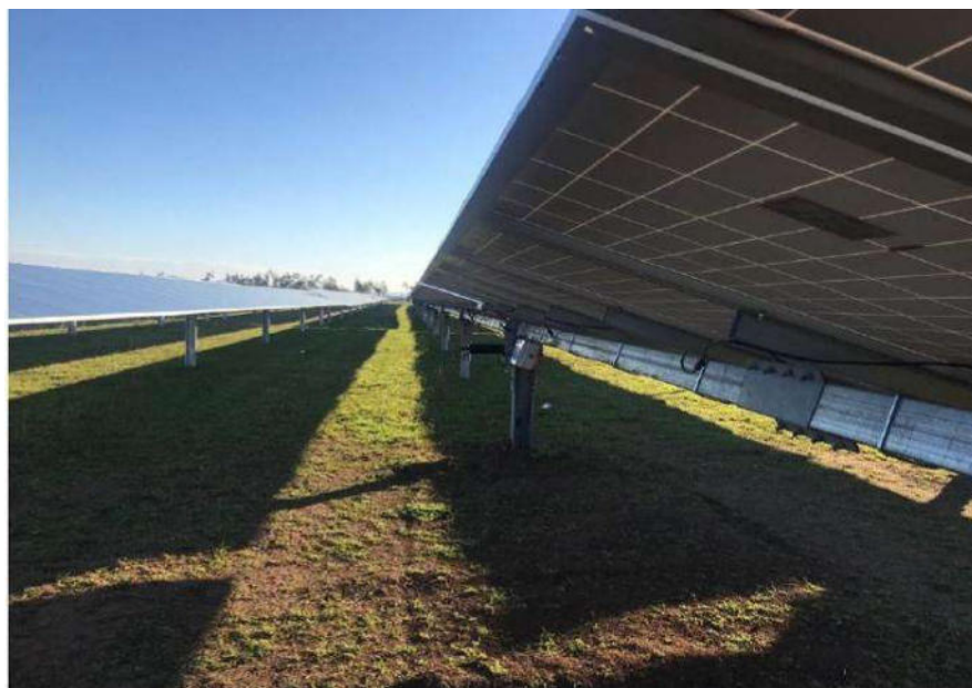
Figura 39: Esempio di impianto fotovoltaico realizzato con supporti costituiti da pali in acciaio infissi direttamente nel terreno. Gli impatti sul suolo sottostante risultano essere minimizzati.
