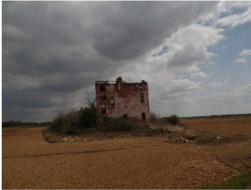
Figura 19: Visuale dell'edificio parzialmente diroccato situato nel settore centro-occidentale dell'area di intervento.
