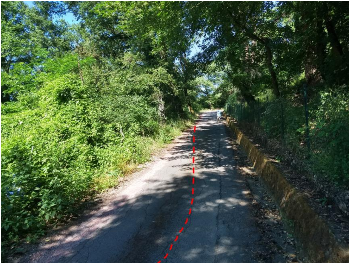
Figura 11.9 - Carreggiata deformata nei pressi della curva n. 1. La linea tratteggiata indica la zona deformata.
