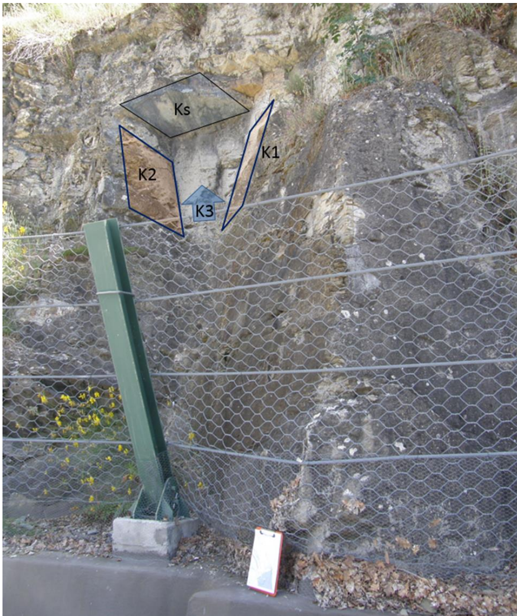
Figura 11.5 – Il cuneo di roccia mancante ben evidenzia le famiglie di discontinuità principali.
