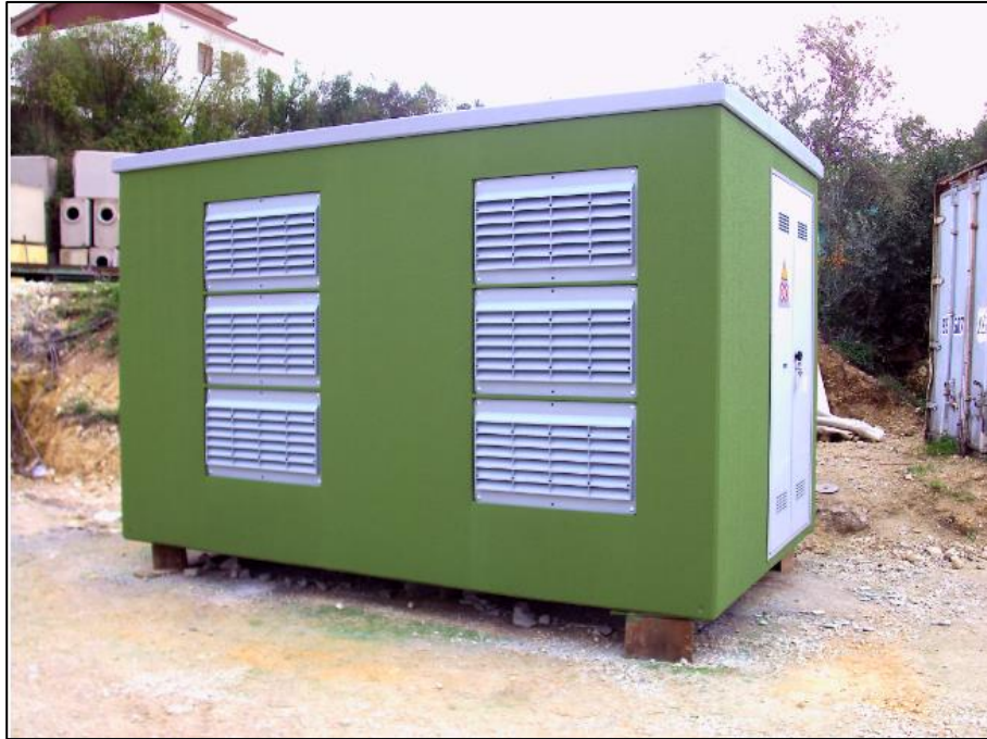
Tipico cabina elettrica prefabbricata
