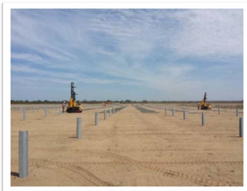
Figura 14 – Foto esempio di Impianti realizzati con stessa struttura
