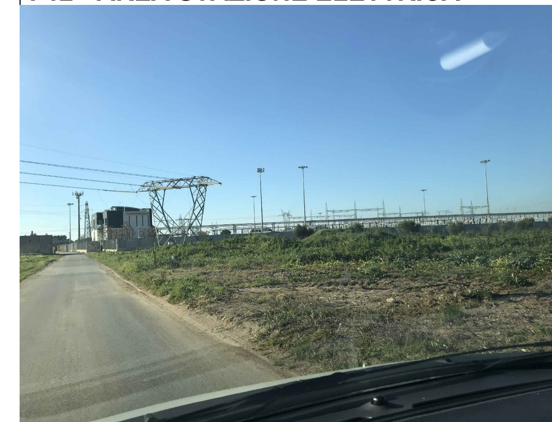
F12 - AREA STAZIONE ELETTRICA
