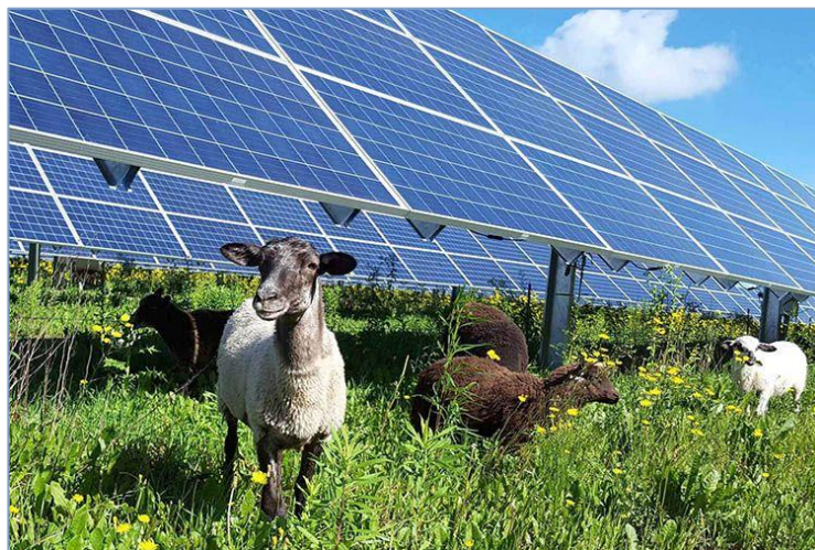
FIGURA 3: FOTO ESEMPLIFICATIVA STRUTTURA FISSA TIPO PER AGRIVOLTAICO
