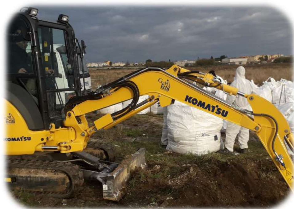
FOTO 6: Prosecuzione delle attività di MISE mediante scavo a sezione obbligata tramite utilizzo di appositi mezzi meccanici, 18/12/2020
