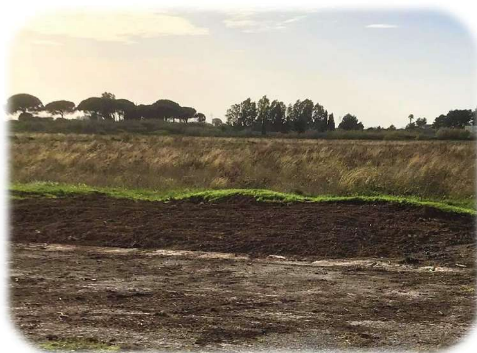
FOTO 16: Ripristino dello stato dei luoghi, per rendere l'area fruibile agli utilizzi antecedenti l'avvenuto sversamento, 07/01/2021
