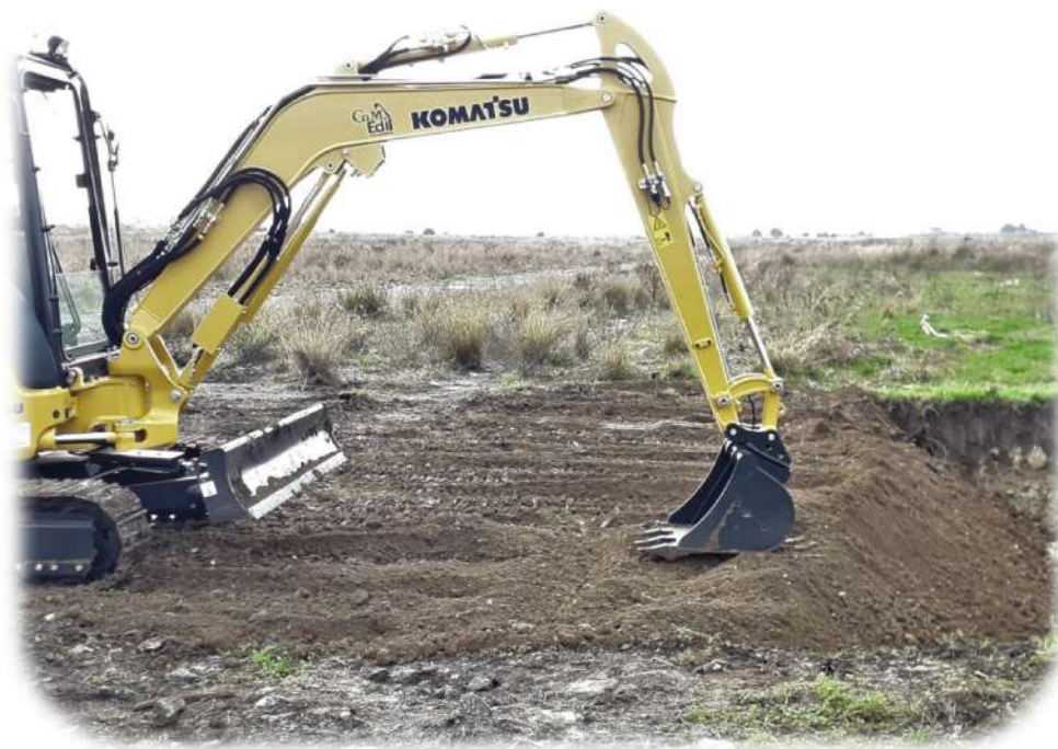
FOTO 15: Procedendo col ripristino mediante stesura e la compattazione del terreno, sempre tramite apposite macchine operatrici
