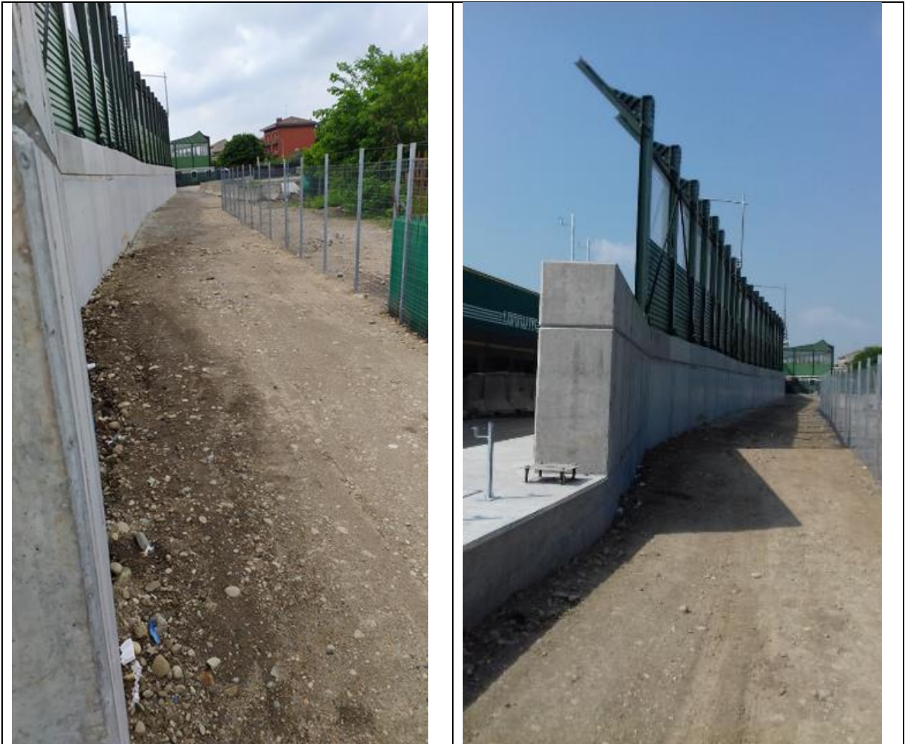
Figura 10. Individuazione e localizzazione del sito di installazione del materiale fotocatalitico: lato esterno alla carreggiata (background)
