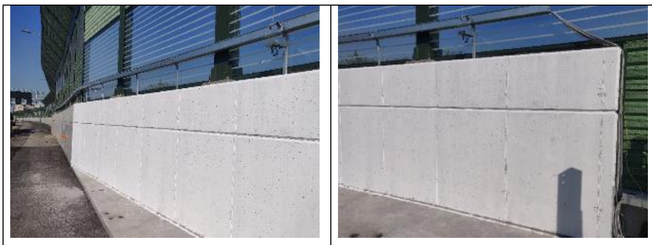
Figura 17. Supporto in cls posto lungo la carreggiata con applicazione della vernice fotocatalitica
