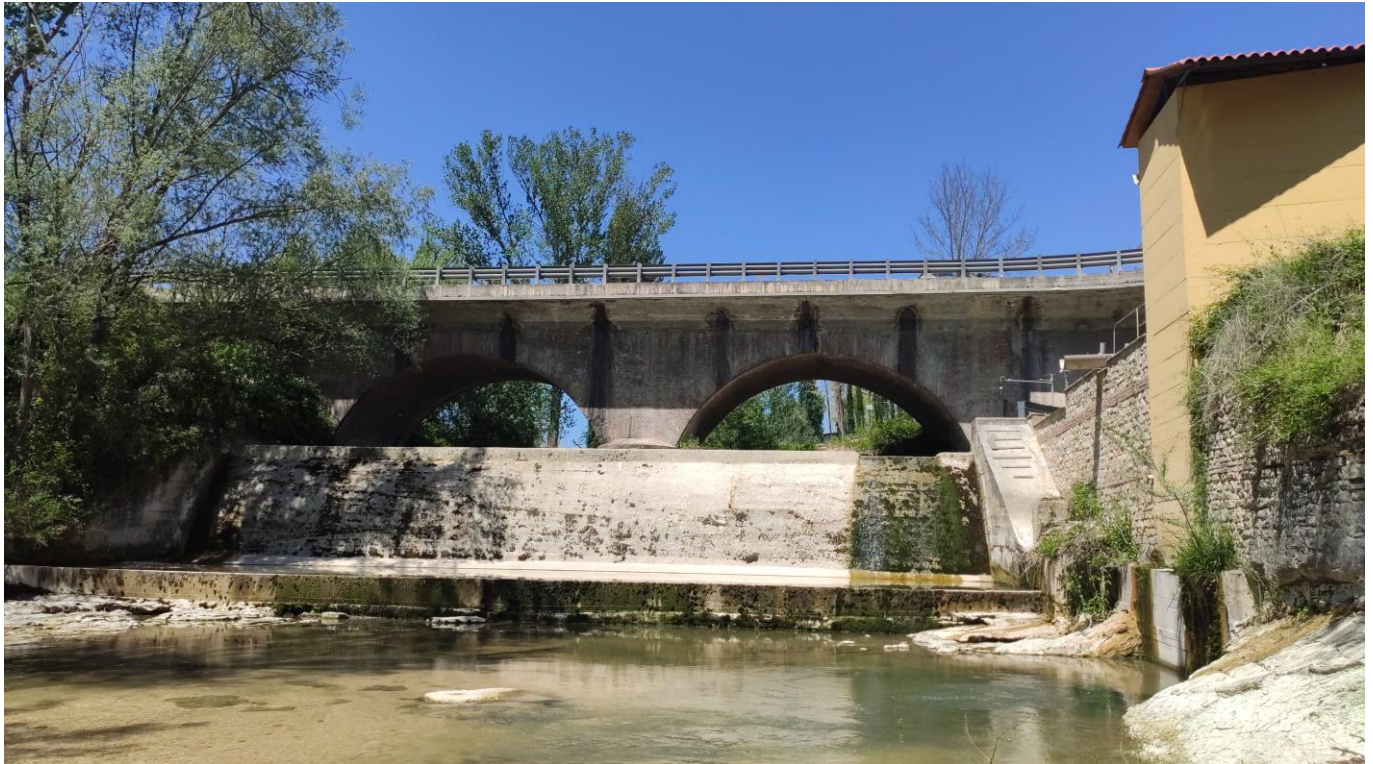
Fig. 3 – Ponte stradale esistente sul Torrente Giano, in corrispondenza del passaggio a livello alla progressiva Km 229+436.
