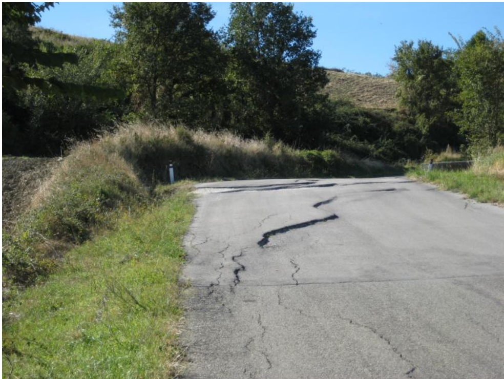
Foto 5- Strada dissestata nei pressi di Fresagrandinara
