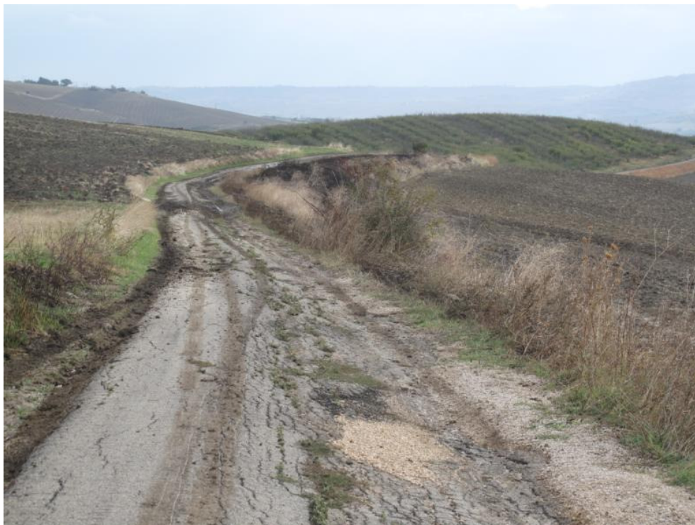
Foto 7-Colate di fango su strada dissestata dopo un evento meteorico
