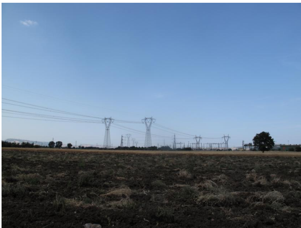
Foto 9-Stazione elettrica di Larino
