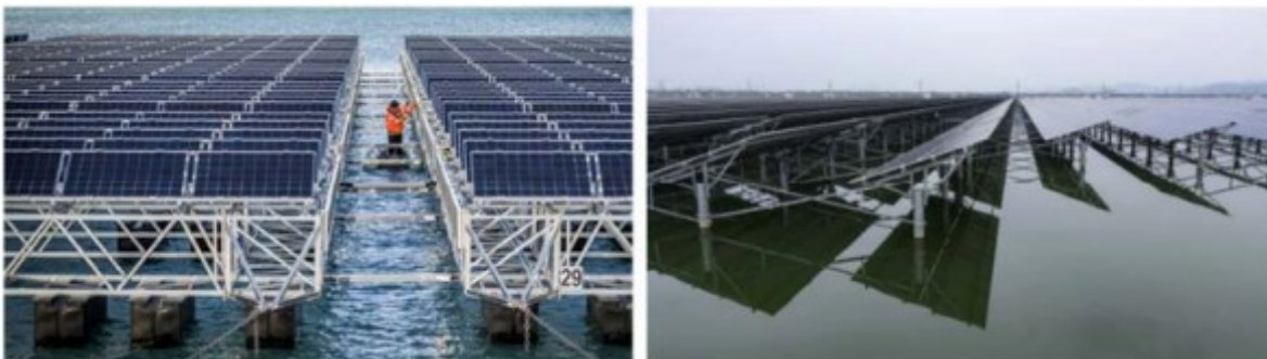
Figura 2: strutture di sostegno costituite da travi leggere reticolari in acciaio con profili laminati a freddo galleggianti (a sinistra) e fisse (a destra).
