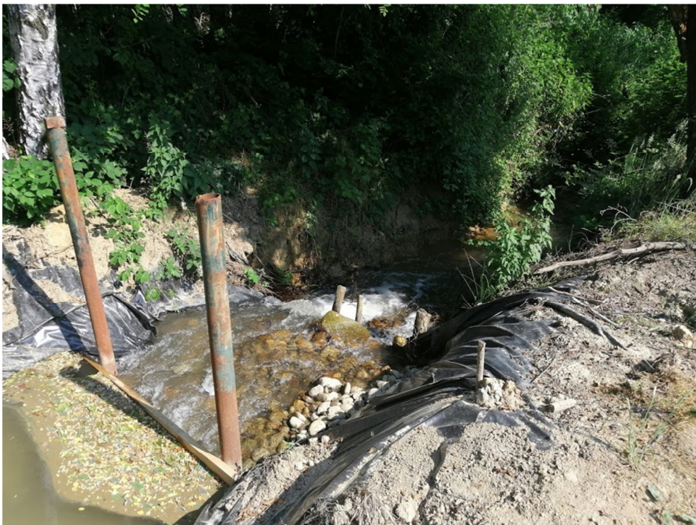
FOTO. 2 – Particolare di argini a carico del cavo al margine Nord
