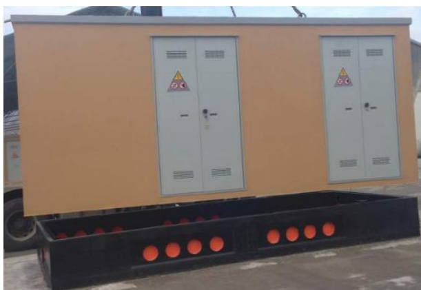
Figura 3-9 – tipologia delle cabine di sezionamento
