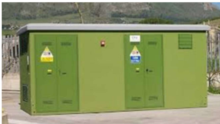
Figura 5: Tipico cabina prefabbricata
