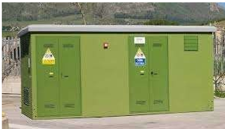
Figura 23: Cabina prefabbricata tipica utilizzata in progetto
