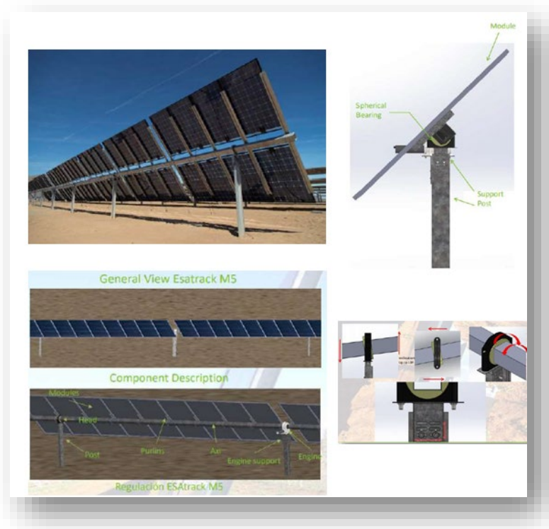
Figura 6 - Strutture di sostegno e sistema di inseguimento solare
