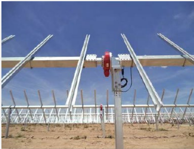
Figura 9- Struttura dell'inseguitore solare monoassiale
