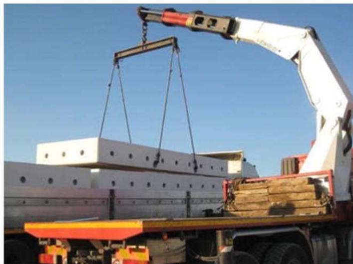
Figura 14 | Scarico cabina trasformazione
