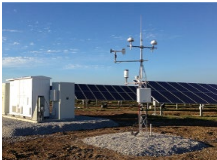
Figura 4-Esempio di stazione meteorologica
