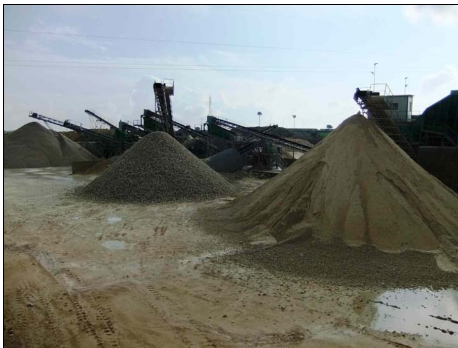
Foto 14 - Particolare impianto frantumazione Cava Spartivento
