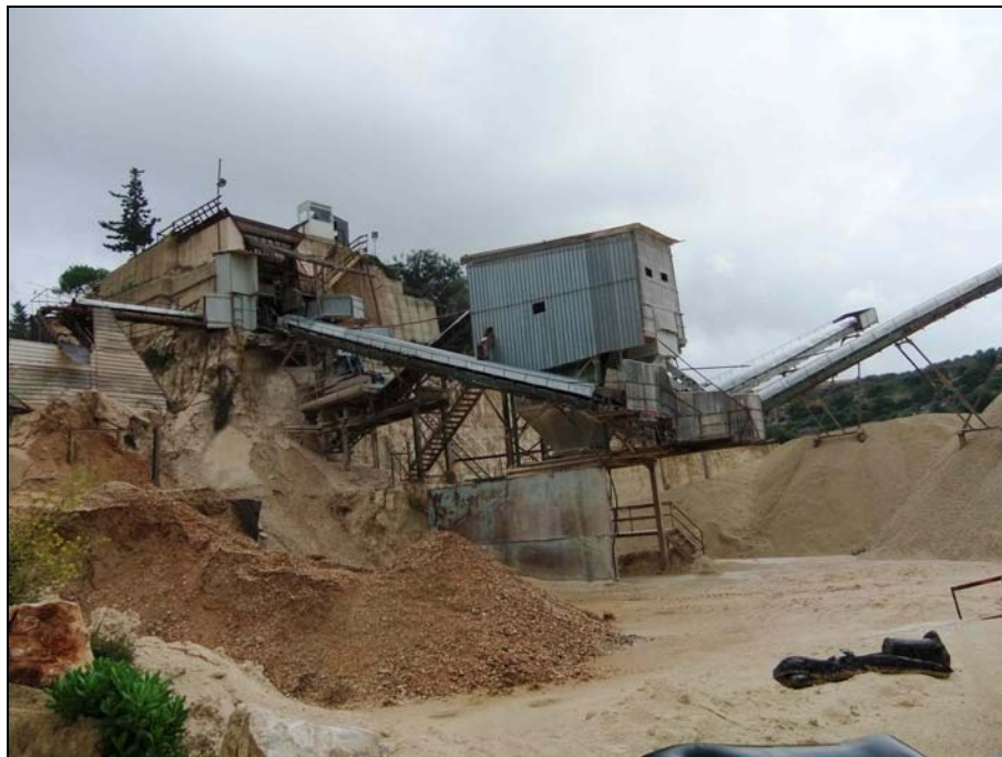
Foto 23 - Panoramica impianto frantumazione Cuffaro
