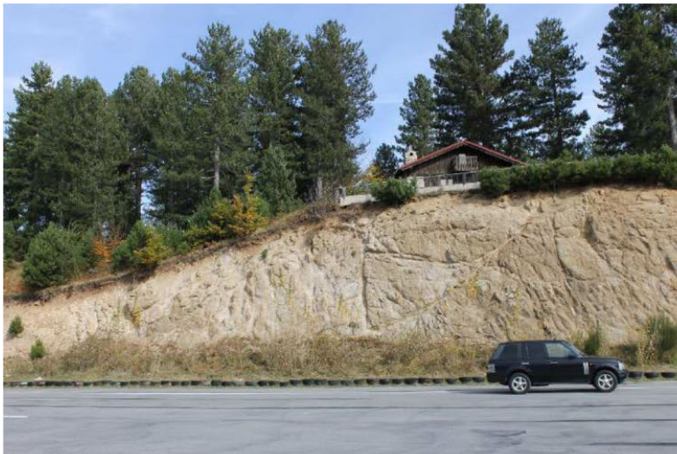
Fig.1 – Litotipi granitoidi fratturati ed alterati lungo il versante di fine pista
