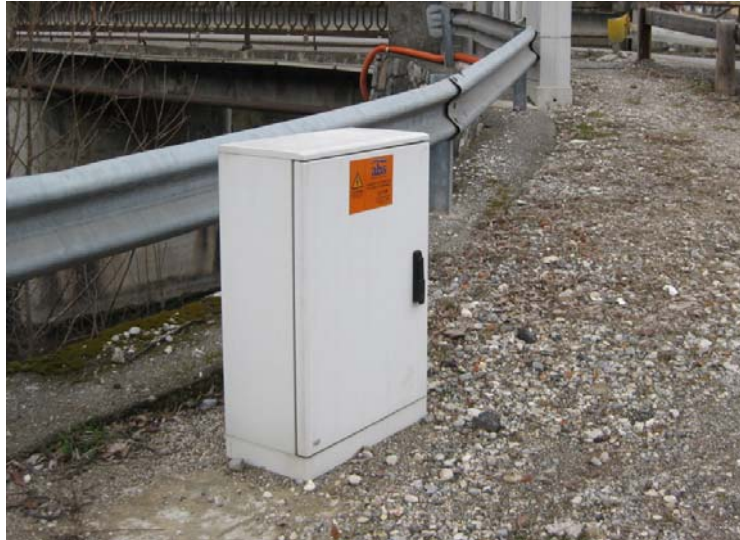
Figura 24 – Cabina alimentazione elettropompe presente all'incrocio di via Roberto Bertini e via dei Baicc.
