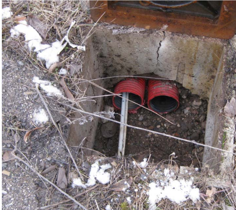
Figura 23 – Pozzetto con cavi elettrici interrati interferente con le opere di progetto di difesa spondale.
