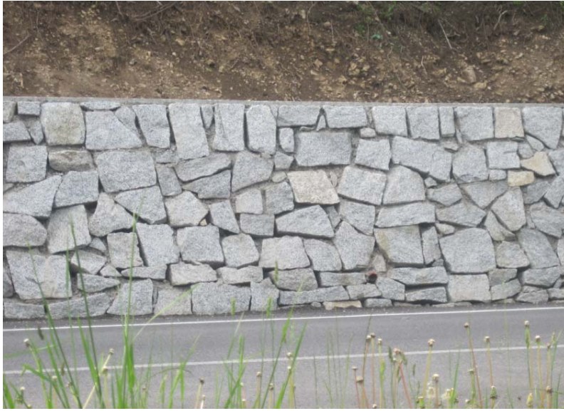
Figura 13: particolare dei rivestimenti in granito delle murature che caratterizzano le infrastrutture viarie nella zona di imbocco.
