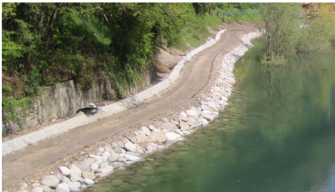
Figura 51: difesa di sponda esistente della riva destra del lago nei pressi del ponte di Idro.
