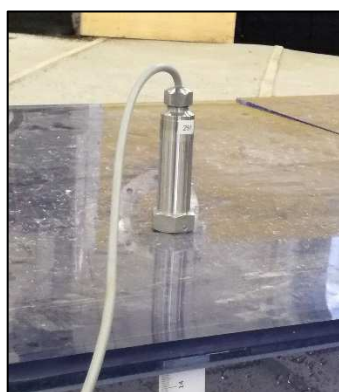
Figura 31. Trasduttore di pressione installato sul canale di restituzione e caratteristiche tecniche
