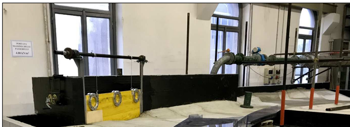
Figura 23. Linea DN150 con misuratore magnetico di portata, canaletta in muratura e paratoia di regolazione per l'alimentazione del Fiume Chiese a monte della confluenza con il canale di restituzione
