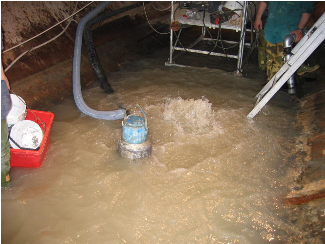
Figura 26 – Risalita d' acqua al fondo della galleria (2004)
