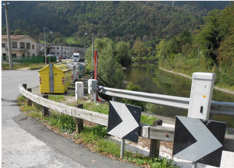
Foto n° 3.3 Armadi quadri posti a lato del ponte
