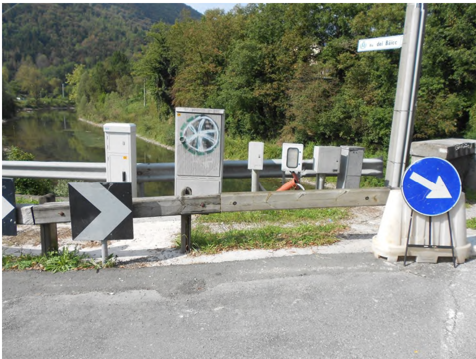
Foto n° 3.2 Armadi quadri posti a lato del ponte
