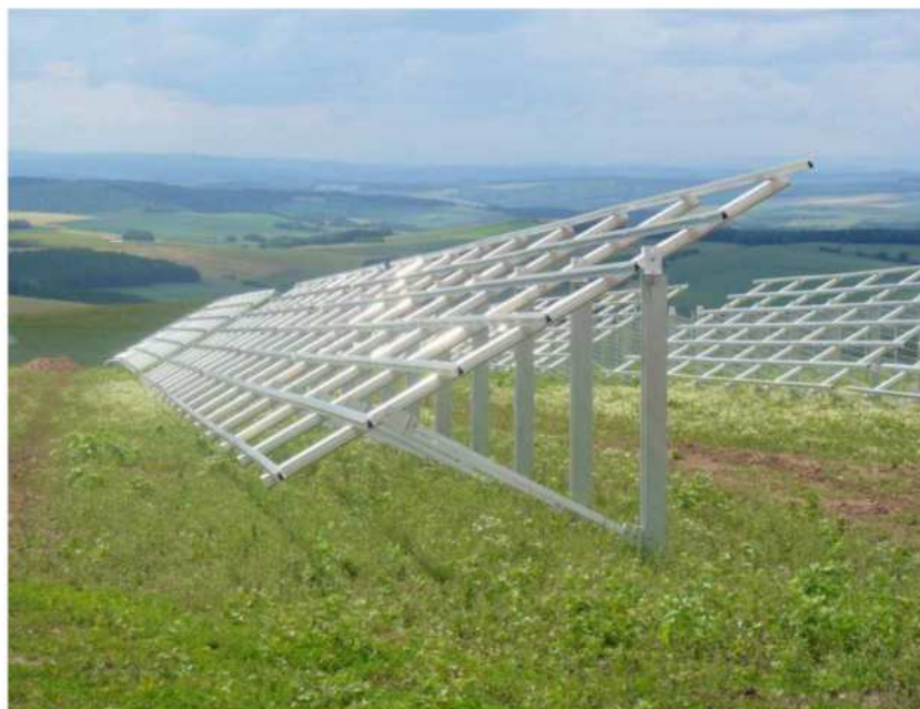
Figura 2 - Strutture di supporto moduli fotovoltaici.
