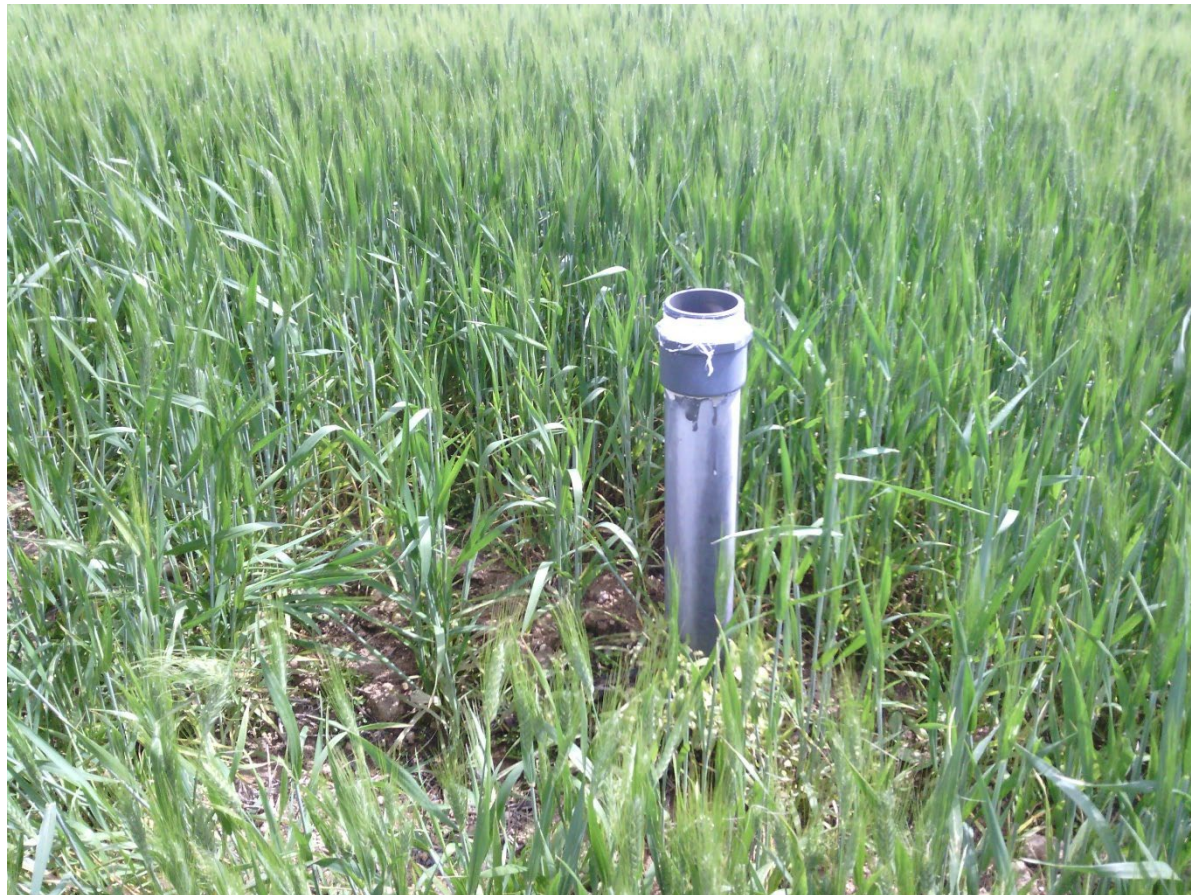
Figura 6: Porzione di sistema di irrigazione interrata - bocchettone visibile fuori terra.
