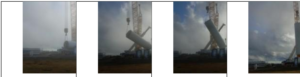
Figura 5.42 – Schema delle fasi di sollevamento dei componenti dell’aerogeneratore (Fonte sito web http://www.windfarmbop.com/ )
