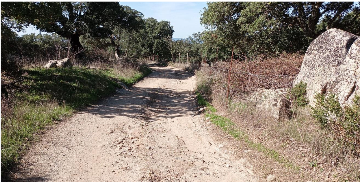
Figura 5.8 – Strada locale da adeguare lungo la viabilità di accesso alla postazione WTG005
