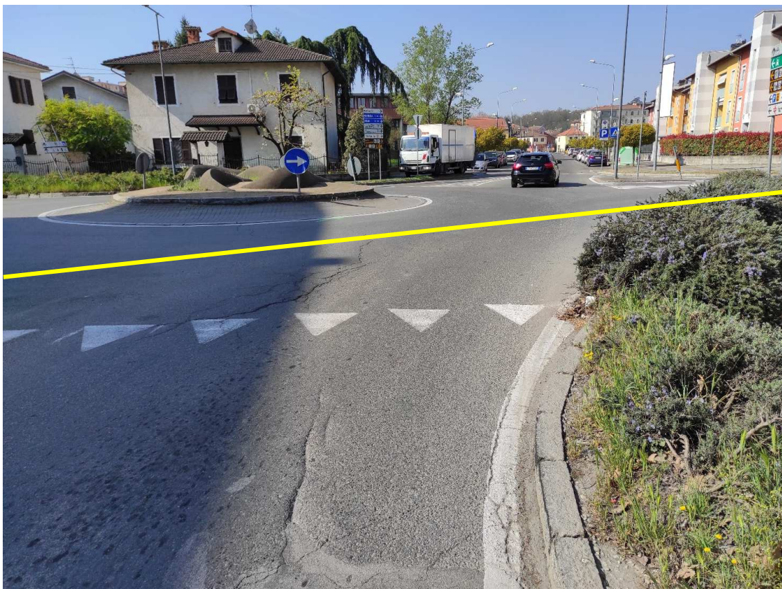
Figura 31. Incrocio Via Carlo Acquistapace-Via Nino Bixio - Posa linea elettrica su strada asfaltata
