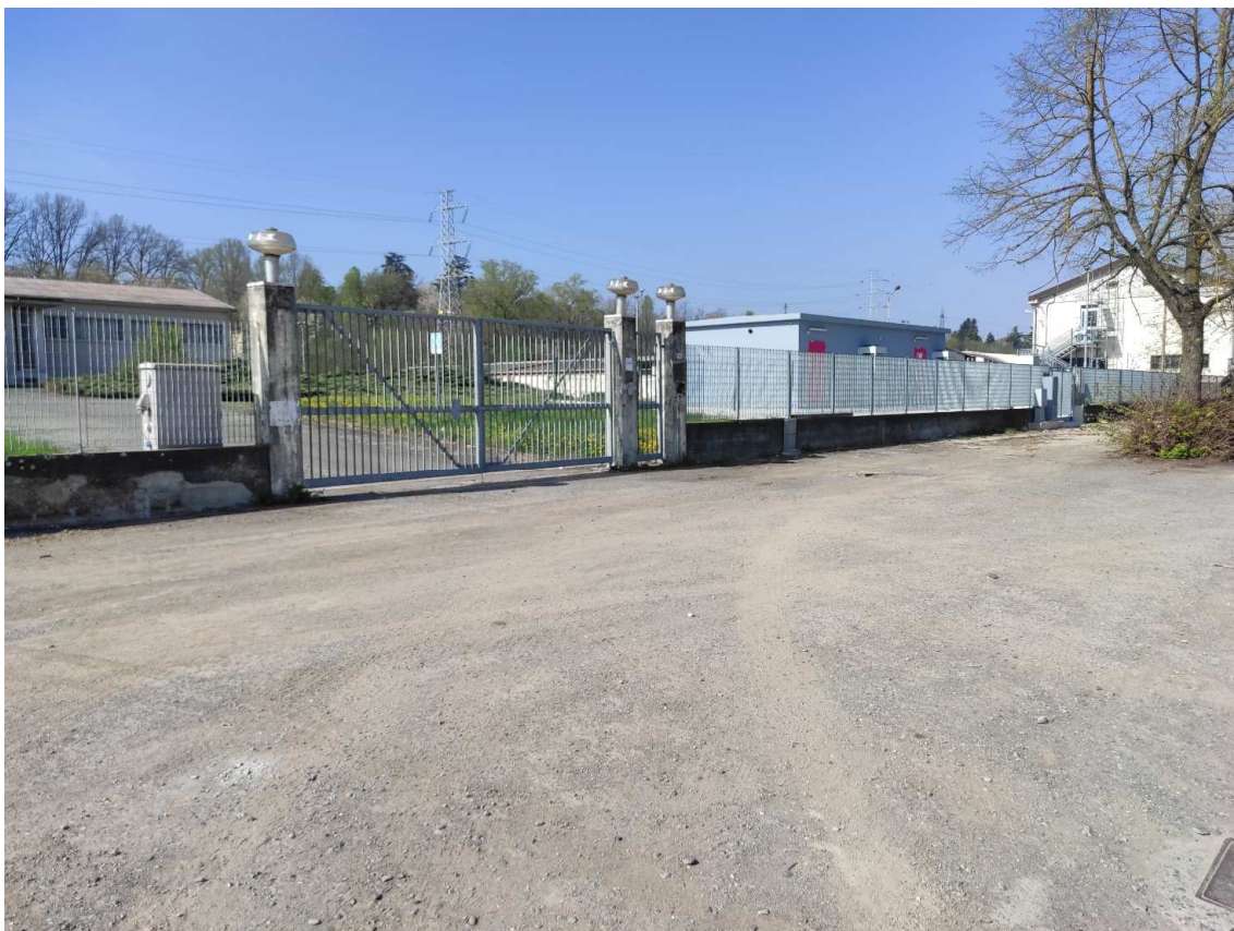
Figura 47. Cabina primaria AT/MT Novi Ligure
