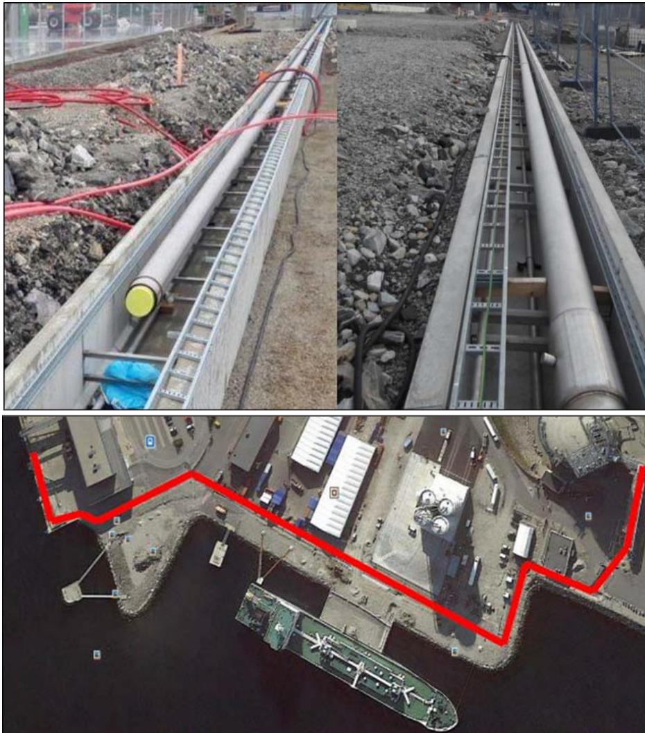
Figura 17 - Impianto di Risavika (Norvegia) con passaggio tubazioni tipo VIP
