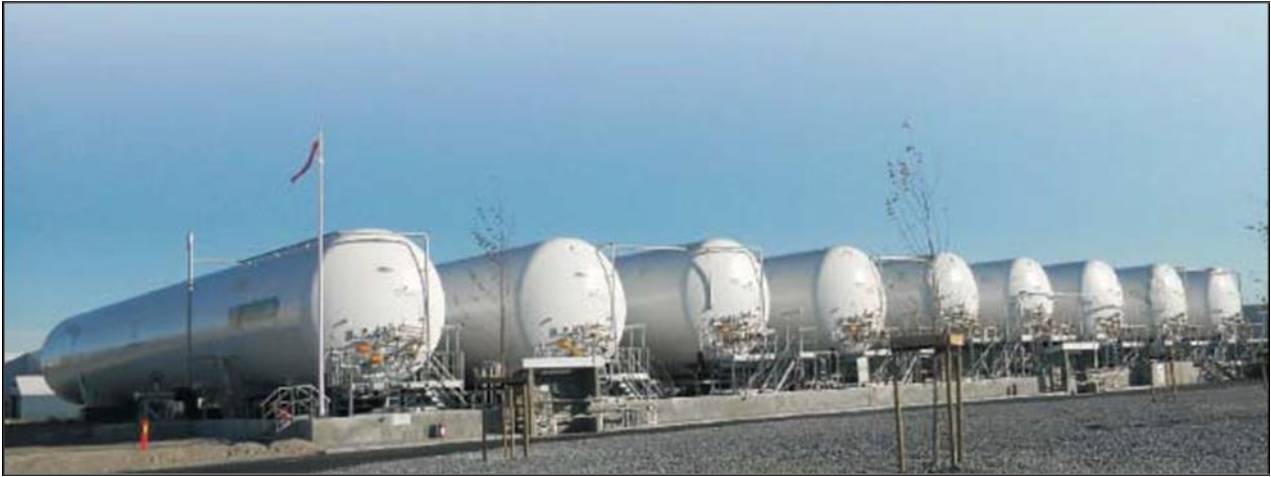
Figura 24 - Esempio di serbatoi criogenici (impianto GNL a Fredrikstad – Norvegia)
