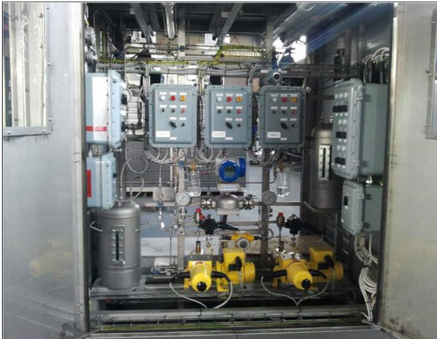
Figura 35 - Sistema di Odorizzazione
