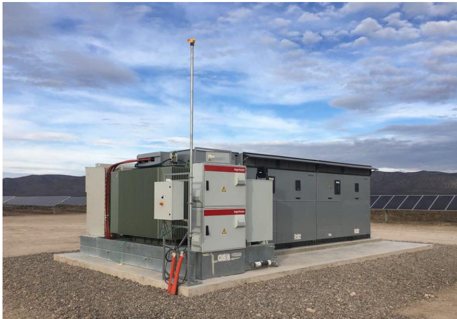
Esempio fotografico di inverter su basamento in c.a.
