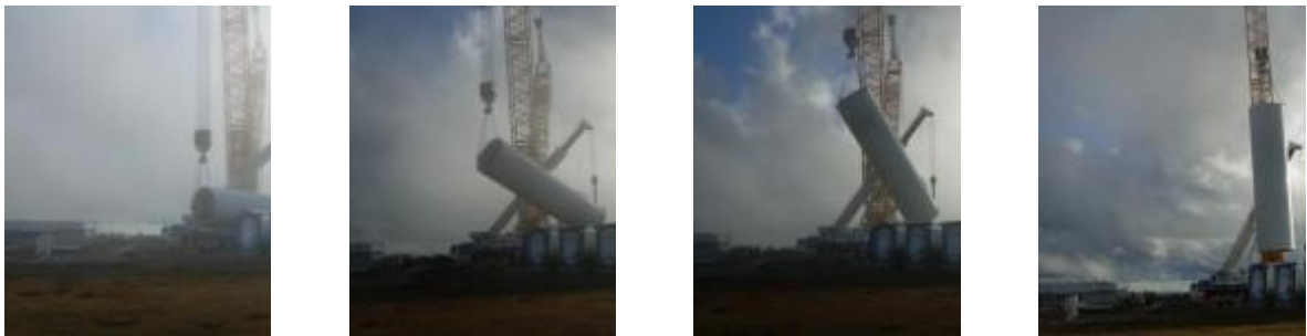
Figura 5.20 – Schema delle fasi di sollevamento dei componenti dell'aerogeneratore (Fonte sito web http://www.windfarmbop.com/ )
