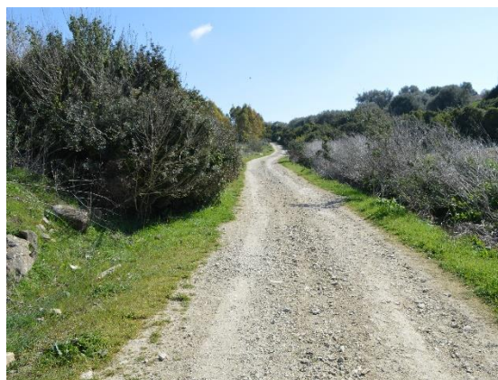
Figura 54 – Sterrato da adeguare
